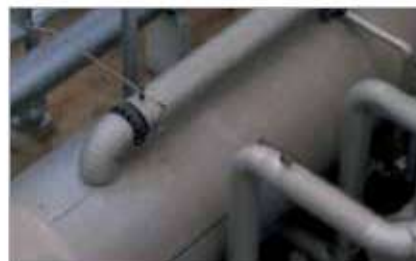
Lavaggi impianti di raffinazione
